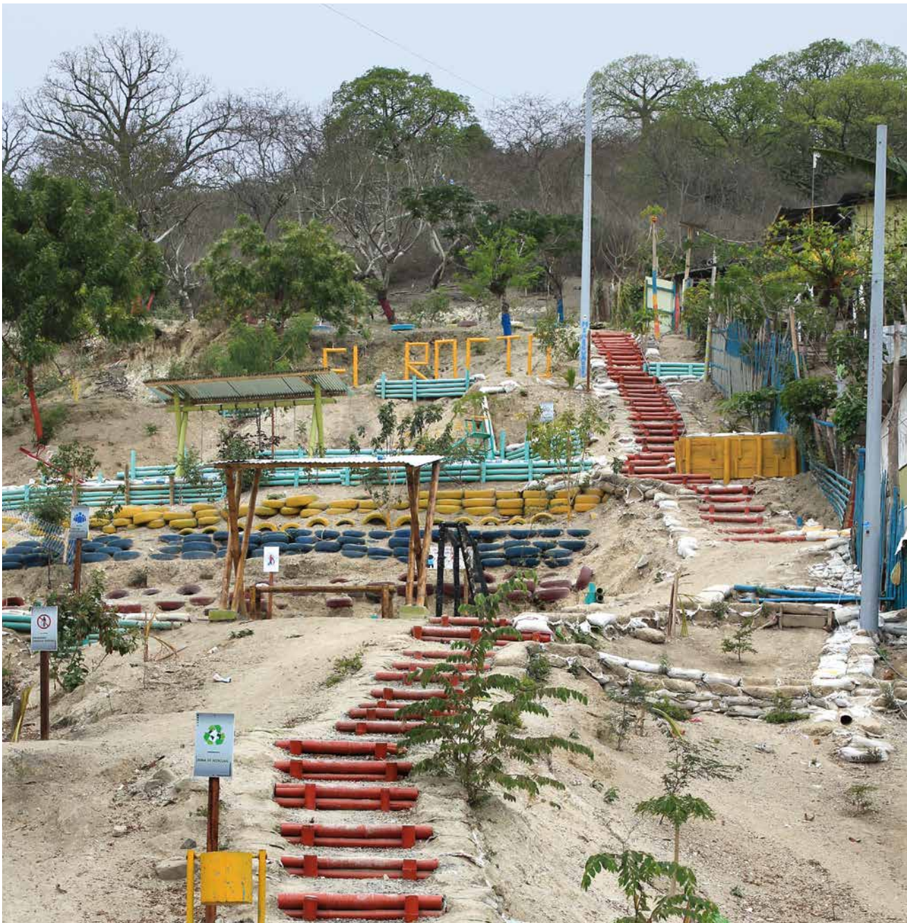
Hangbefestigungen wie diese in San Pablo verringern auch bei starken Regenfällen die Erdrutschgefahr.
