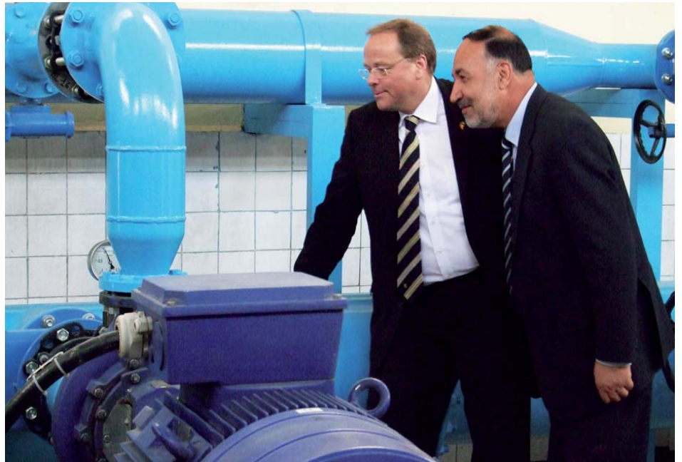
Beim Besuch der Allaoudin Pumpstation lässt sich Minister Dirk Niebel die Technik der Trinkwasserversorgung erklären. Seit 2002 hat das BMZ insgesamt rund 100 Millionen Euro in den afghanischen Wassersektor investiert. Allein in Kabul haben inzwischen mehrere 100.000 Einwohner Zugang zu sauberem Trinkwasser. Foto: GIZ
