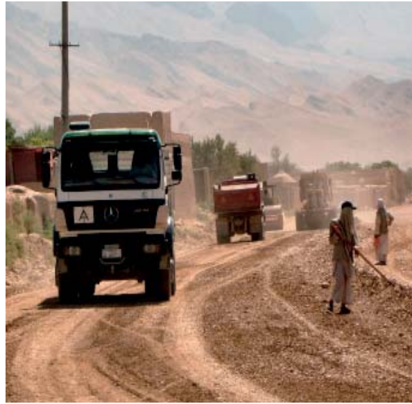
Seit Ende vergangenen Jahres wird am Ausbau der „alten Seidenstraße“ gearbeitet. 15 Kilometer sind schon im Bau. Fotos: GAUFF
