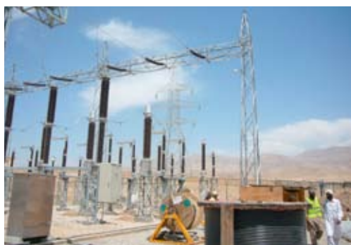
Umspannstation in Mazar-e Sharif. (F: KfW)
