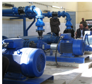
Pumpen für die Trinkwasserversorgung Foto: BMZ
